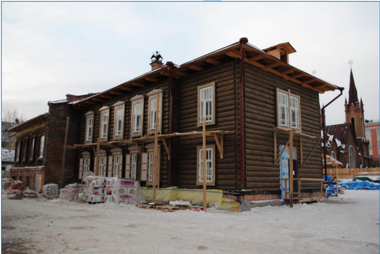
«Флигель усадьбы купца С.В. Телегина», 1900-е гг. (до 1910 г.), г. Красноярск, ул. Горького, 13А.
