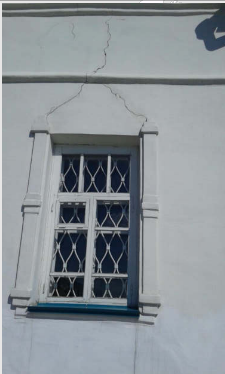
Трещины над оконным проемом западного фасада Спасской церкви
